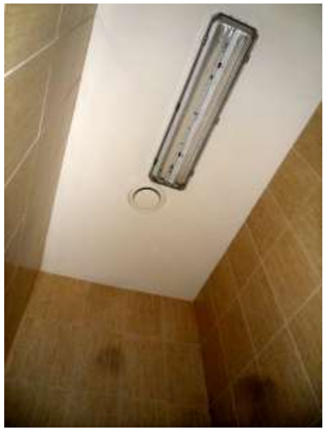
Фото 66 Часть помещения № 42, душевая, потолок и освещение
