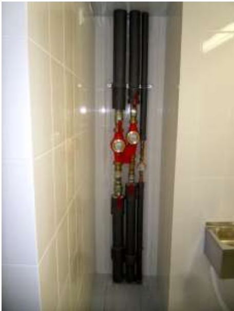
Фото 79 Часть помещения № 53, счетчики расхода воды
