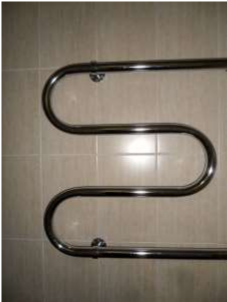
Фото 67 Часть помещения № 42, отопление
