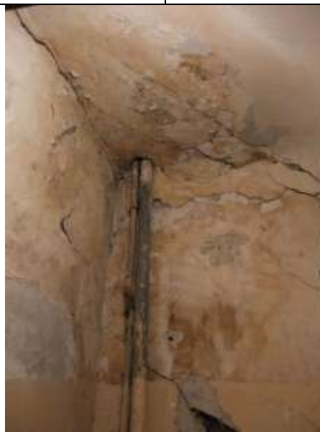
Фото 21 Состояние потолка в ч. п. 2
