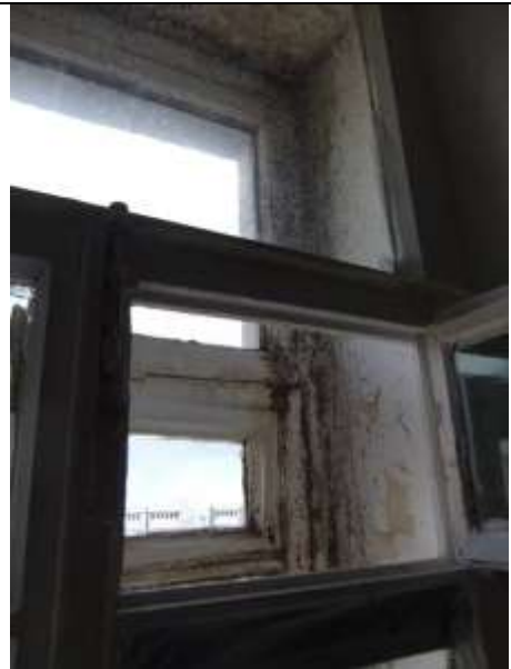
Фото 27 Состояние оконных заполнений в ч. п. 9
