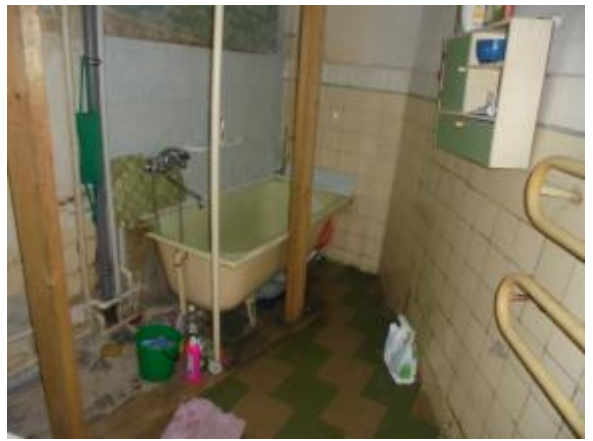
Фото 40 Общий вид и состояние ванной (ч.п. № 10)
