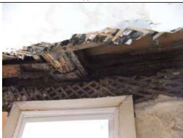
Фото 18 Состояние потолка в ч. п. 3
