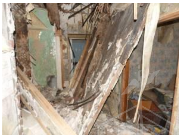
Фото 90 Обрушившийся фрагмент перекрытия
