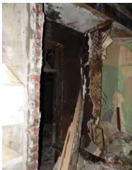
Фото 89 Разрушенная перегородка с соседней квартирой
