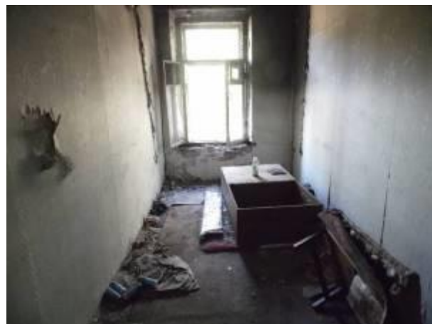
Фото 78 Состояние помещений (комната)
