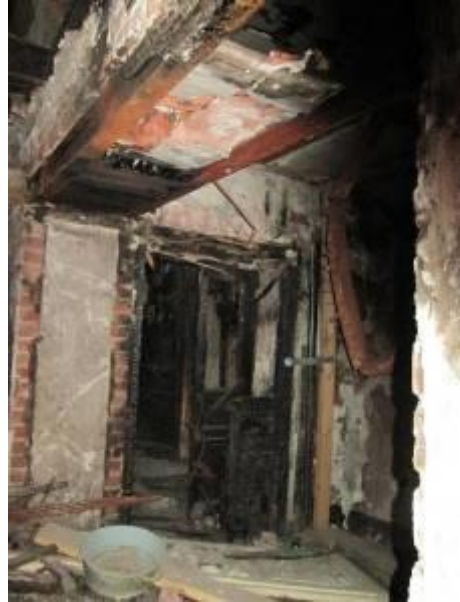
Фото 32 Стена, отделяющая квартиру 18 от лестничной площадки, разрушена
