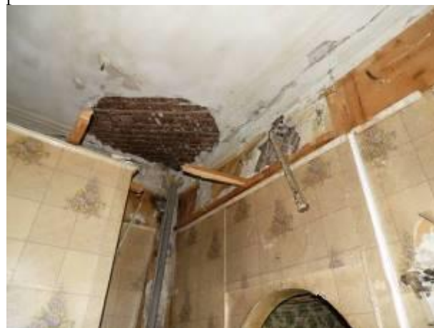
Фото 76 Санузел (состояние потолков)
