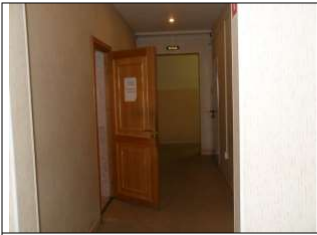
Фото 23 Состояние отделки (кабинет)
