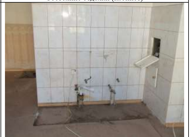
Фото 28 Состояние отделки (зона кухни)
