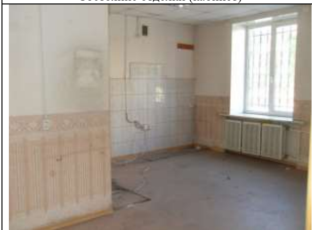
Фото 27 Состояние отделки (зона кухни)
