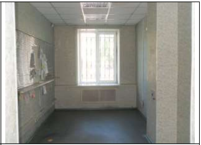
Фото 94 Состояние отделки (кабинет)
