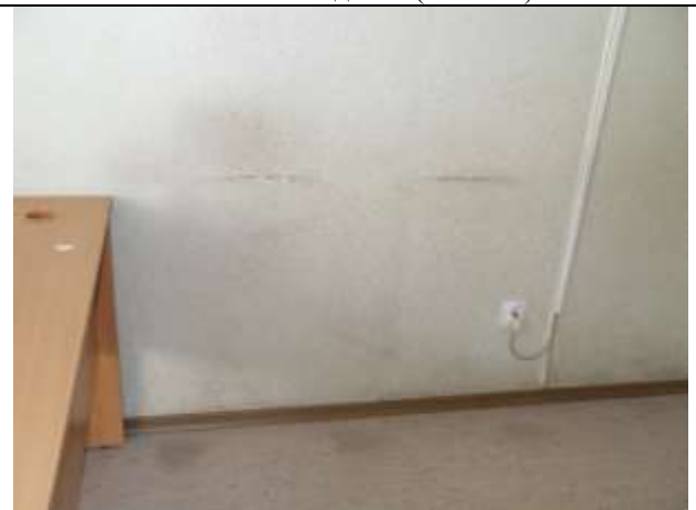
Фото 20 Состояние отделки (кабинет)
