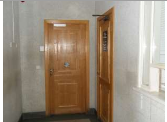
Фото 18 Состояние отделки (кабинет)
