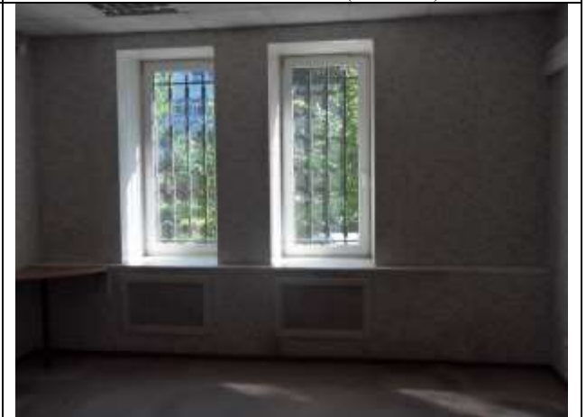
Фото 26 Состояние отделки (кабинет)
