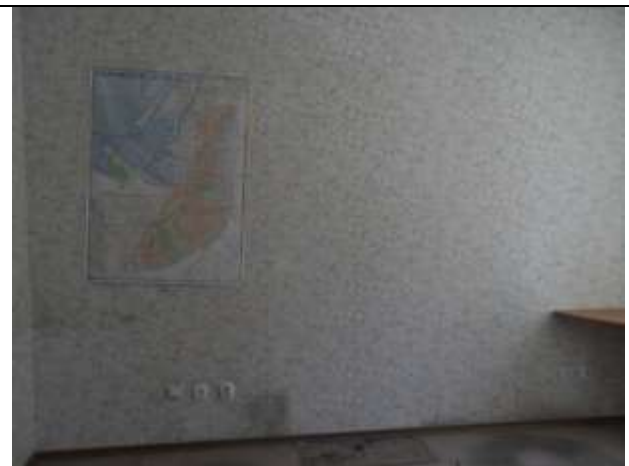
Фото 30 Состояние отделки (кабинет)
