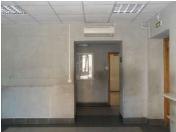
Фото 87 Состояние отделки (кабинет)
