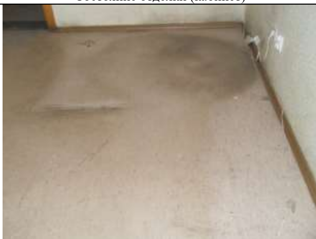
Фото 21 Состояние отделки (кабинет)
