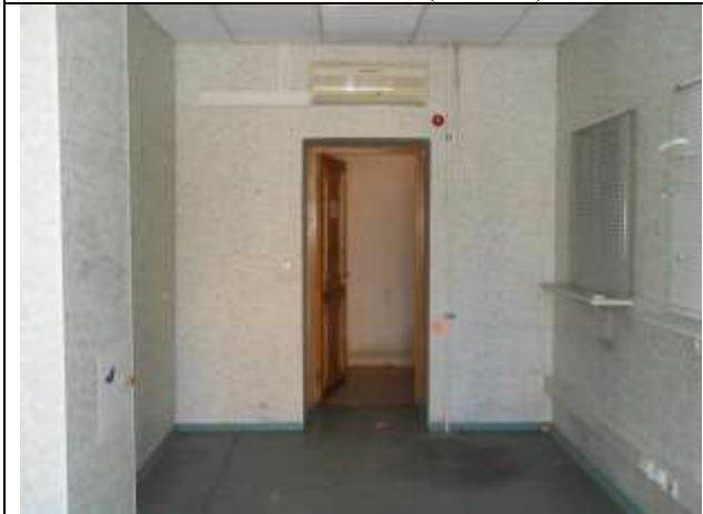
Фото 25 Состояние отделки (кабинет)
