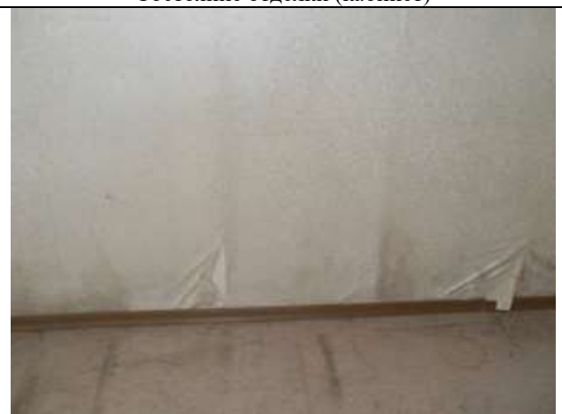
Фото 22 Состояние отделки (кабинет)
