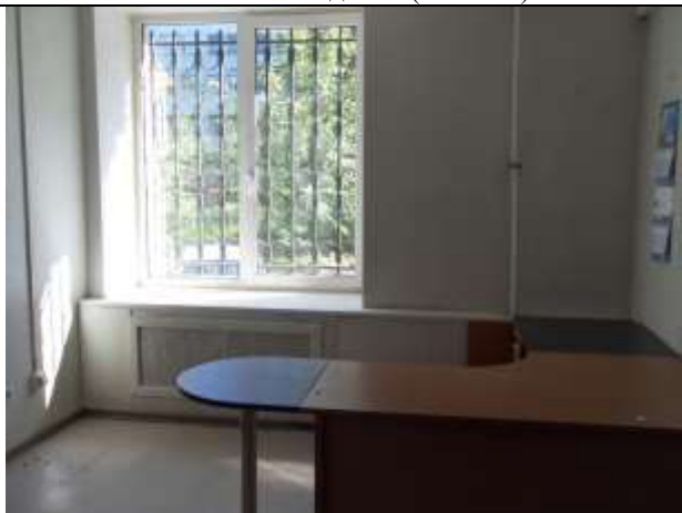
Фото 19 Состояние отделки (кабинет)
