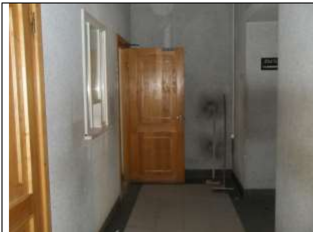
Фото 29 Состояние отделки (кабинет)
