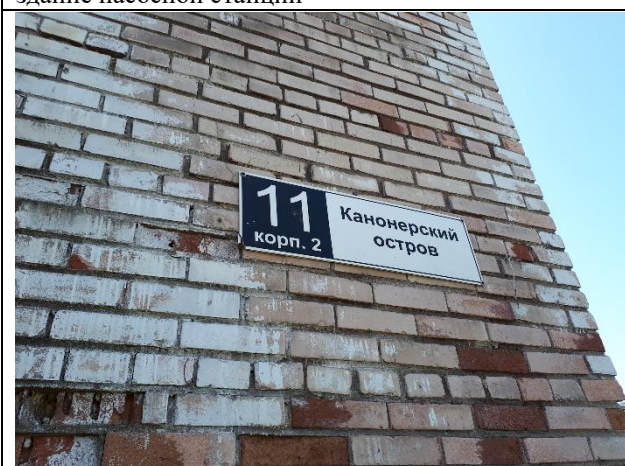
Фото 7. Оцениваемый объект недвижимости – здание насосной станции. Состояние стен
