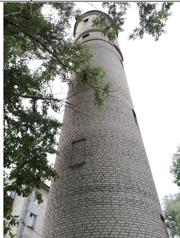
Фото 6. Оцениваемый объект недвижимости – здание водонапорной башни. Состояние конструкций стен и проемов
