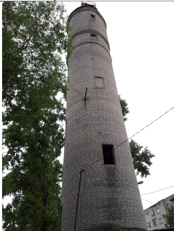
Фото 5. Оцениваемый объект недвижимости – здание водонапорной башни. Состояние конструкций стен и проемов
