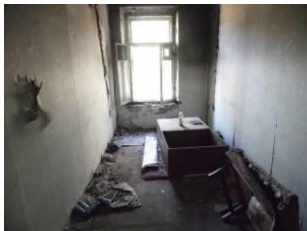
Фото 78 Состояние помещений (комната)
