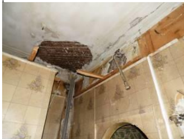
Фото 76 Санузел (состояние потолков)
