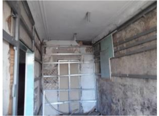
Фото 94 Общий вид кухни
