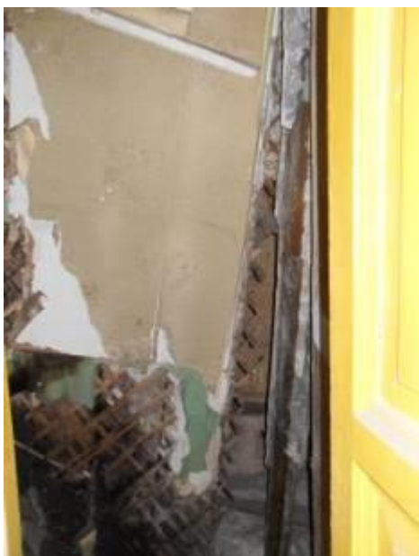
Фото 51 Туалет (нет части стены)
