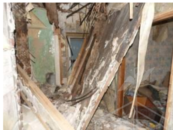
Фото 90 Обрушившийся фрагмент перекрытия
