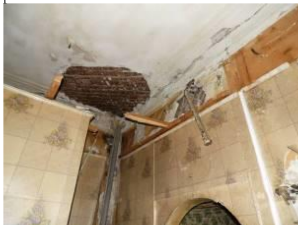
Фото 76 Санузел (состояние потолков)
