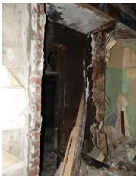
Фото 89 Разрушенная перегородка с соседней квартирой
