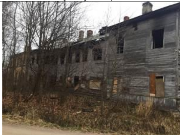
Фото 6. Вид дома. Отсутствие остекления в большей части оконных проемов
