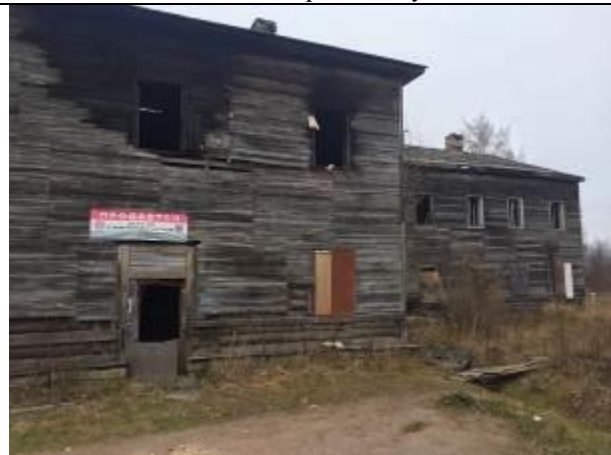
Фото 5. Вид фасада здания со стороны Оранжевой улицы. Здание частично подверглось пожару. Оконные проемы частично заколочены.
