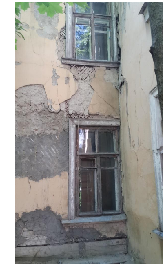
Фото 12. Состояние стен (перекосы стен, отпадение штукатурного слоя, сырость)
