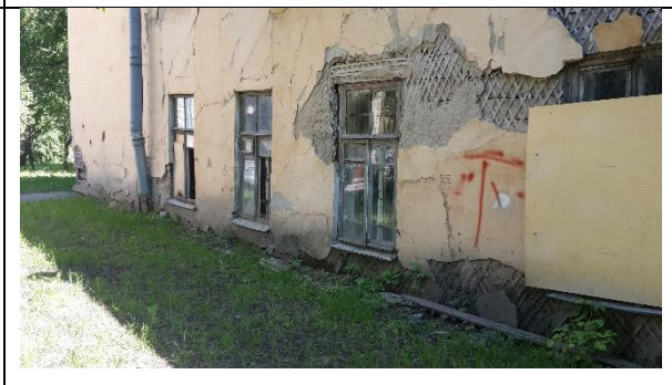
Фото 14. Состояние стен (отпадение штукатурного слоя, трещины)
