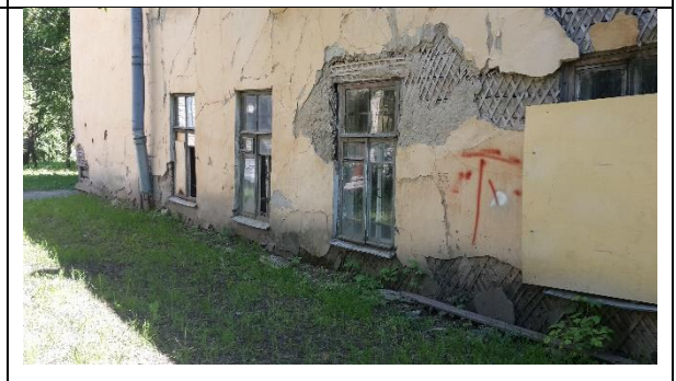
Фото 14. Состояние стен (отпадение штукатурного слоя, трещины)
