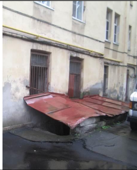
Фото 22. Недействующий запасной вход в помещение
