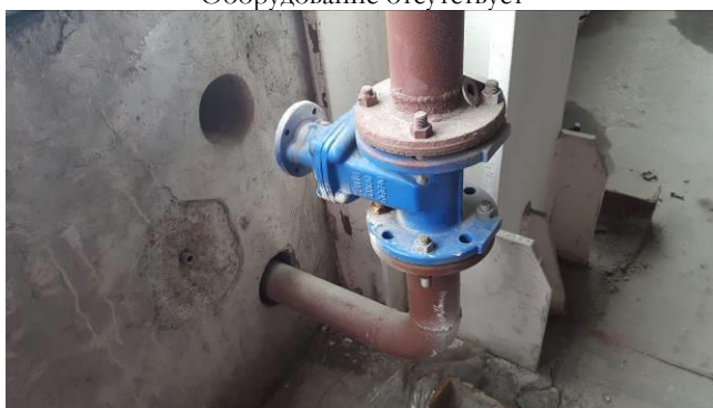
Фото 25 Состояние системы водоснабжения здания
