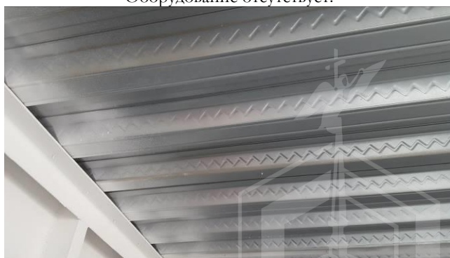
Фото 26 Состояние потолочных перекрытий.
