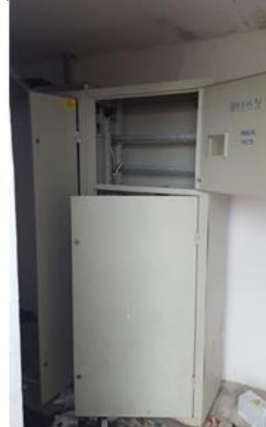
Фото 14 Отсутствие оборудования в техническом помещении здания
