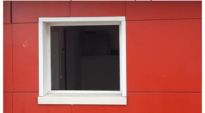
Фото 12 Отсутствие оконного заполнения, 1 этаж.
