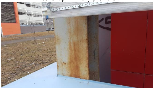
Фото 21 Состояние ограждения здания
