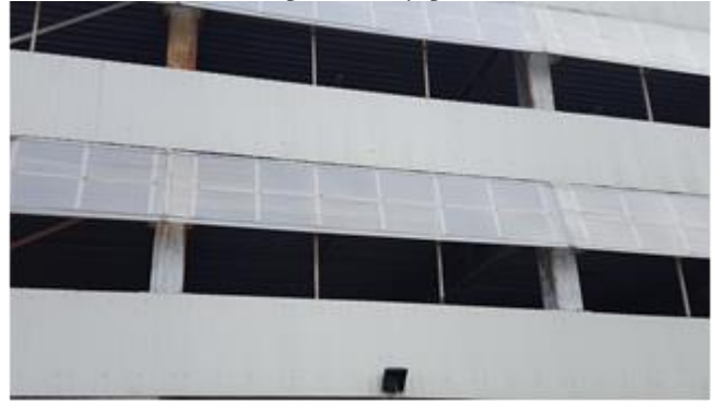
Фото 20 Состояние ограждения здания
