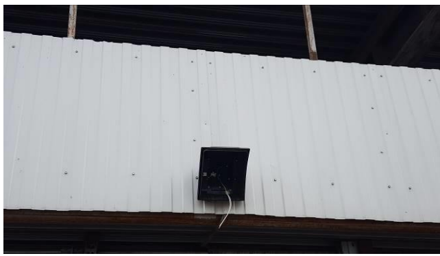
Фото 15 Наружное освещение здания утрачено
