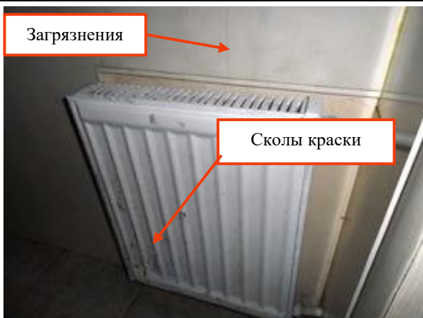
Фото 67. Часть помещения №8 помещения 6-Н, радиатор отопления
