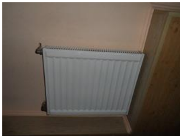
Фото 62. Часть помещения №7 помещения 6-Н, радиатор отопления
