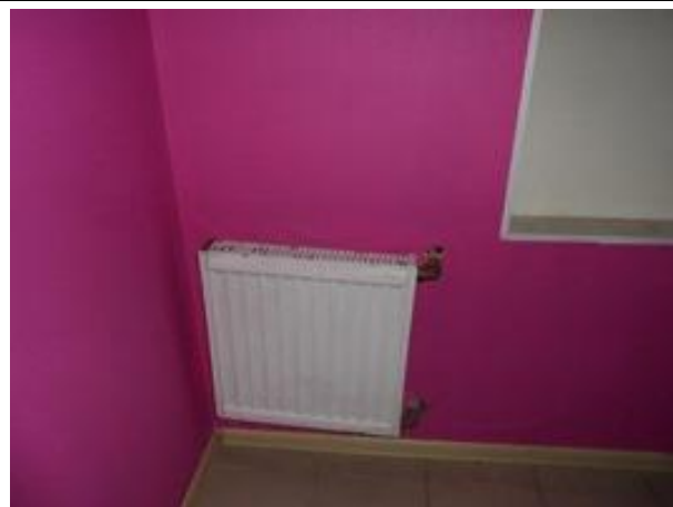
Фото 54. Часть помещения №6 помещения 6-Н, радиатор отопления
