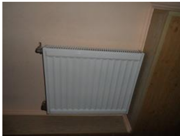
Фото 62. Часть помещения №7 помещения 6-Н, радиатор отопления
