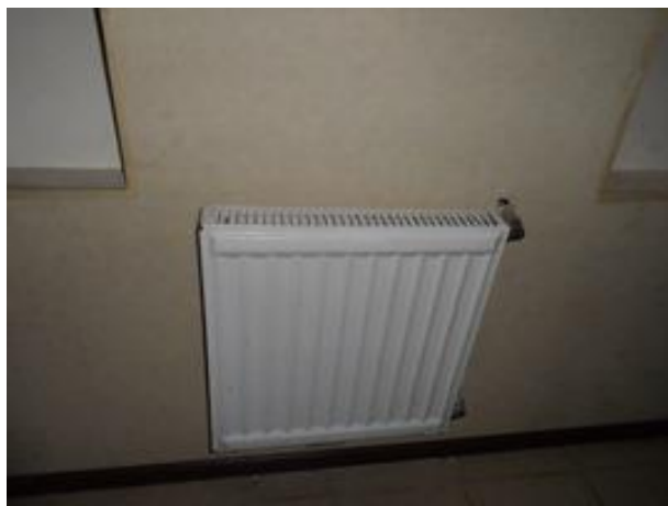
Фото 46. Часть помещения №5-6 помещения 6-Н, радиатор отопления
