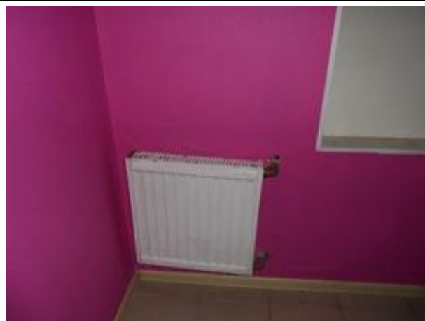
Фото 54. Часть помещения №6 помещения 6-Н, радиатор отопления
