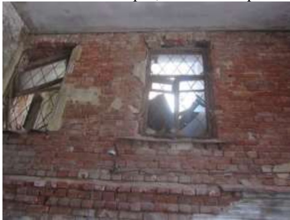
Фото 9. Состояние соседнего подъезда
