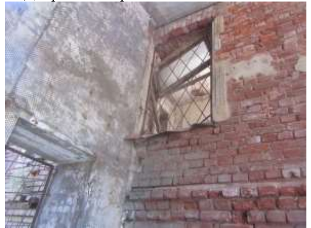
Фото 10. Состояние соседнего подъезда
