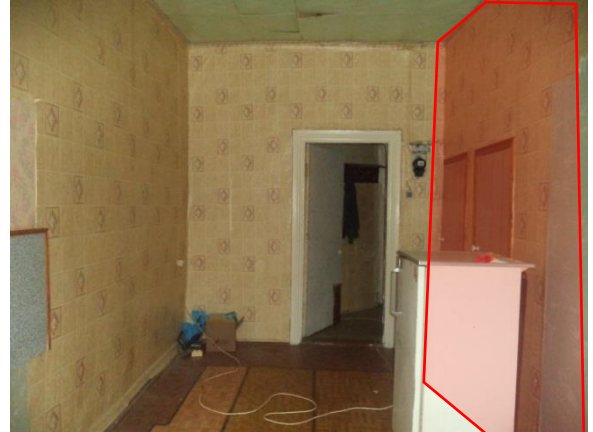
Фото 25 Общий вид и состояние помещения (ч.п. № 3 – выполнена самовольная перепланировка – выполнен монтаж перегородок разделяющий помещение на 3 части – два жилых помещения и санузел, красным отмечена перегородка)
