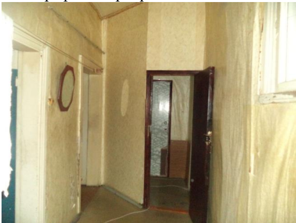
Фото 18 Общий вид и состояние помещения (ч.п. № 4, выполнена самовольная перепланировка – организован тамбур со входом (отмечен красным) перед пом. №№ 2, 3 за счет монтажа перегородок)
