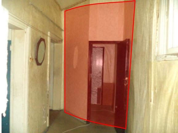
Фото 24 Общий вид и состояние помещения (ч.п. № 4, выполнена самовольная перепланировка – организован тамбур со входом (отмечен красным) перед пом. №№ 2, 3 за счет монтажа перегородок)
