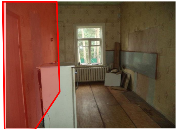
Фото 23 Общий вид и состояние помещения (ч.п. № 3 – выполнена самовольная перепланировка – выполнен монтаж перегородок с входами, разделяющих помещение на 3 части – два жилых помещения и санузел, красным отмечена перегородка)
