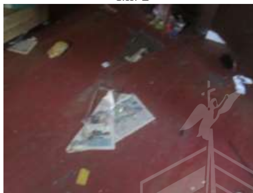
Фото 15. Состояние пола ч.п. 2
