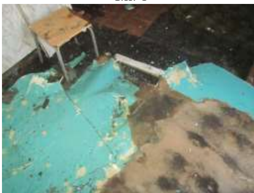
Фото 20. Ч.п. VIII состояние полов
