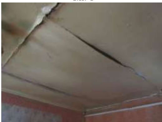
Фото 14. Состояние потолка ч.п. 2
