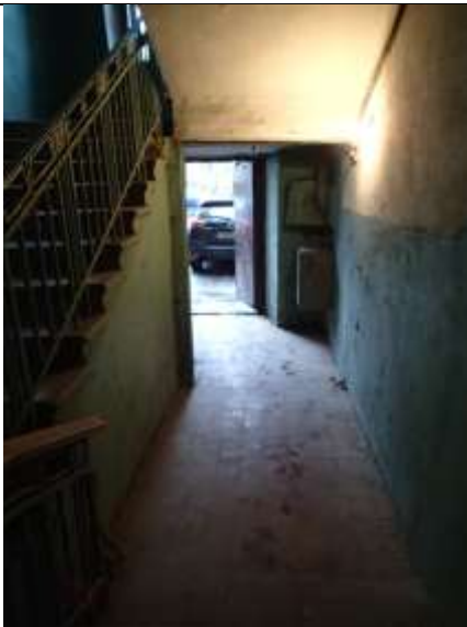
Состояние отделки подъезда Объекта оценки
