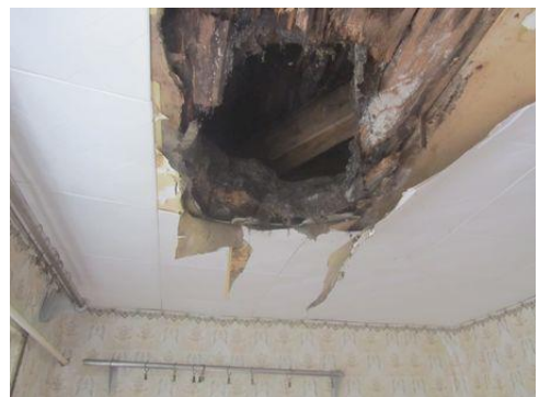
Фото 22. Ч.п. VII состояние потолков
