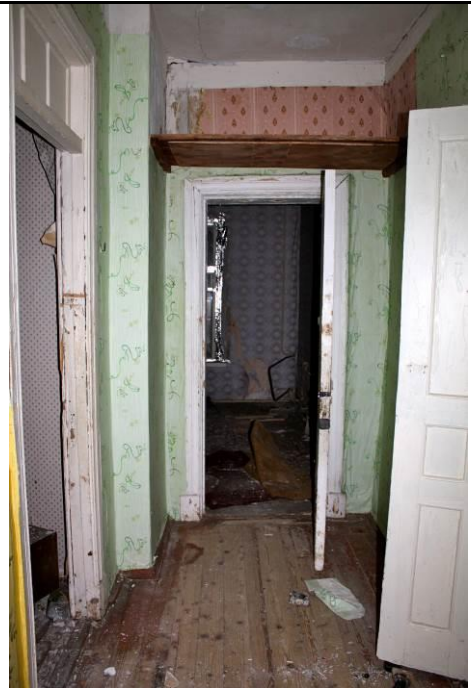
Фото 28: Общий вид ч.п.1, двери в ч.п.8,9
