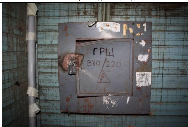
Фото 124: Главный распределительный щит здания
