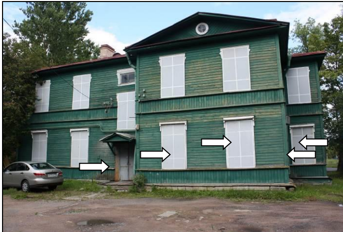
Фото 1: Фасад здания (вид с улицы/со двора). Общий с жилыми помещениями вход. Окна оцениваемой квартиры.
