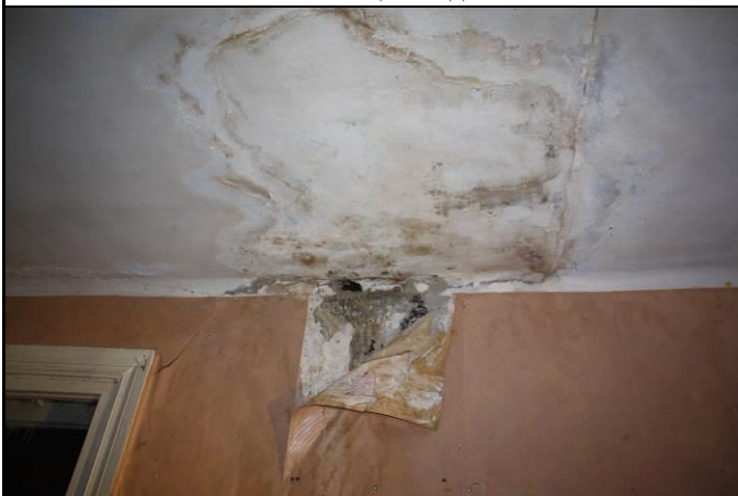
Фото 89: Состояние потолочного покрытия в ч.п.8
