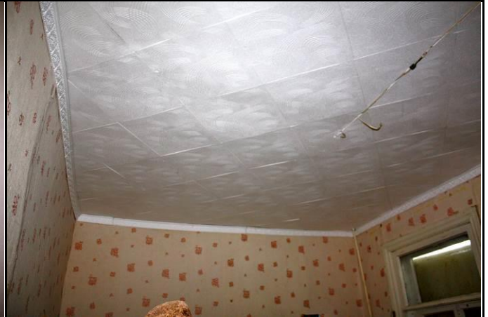
Фото 58: Состояние потолочного покрытия в ч.п.7
