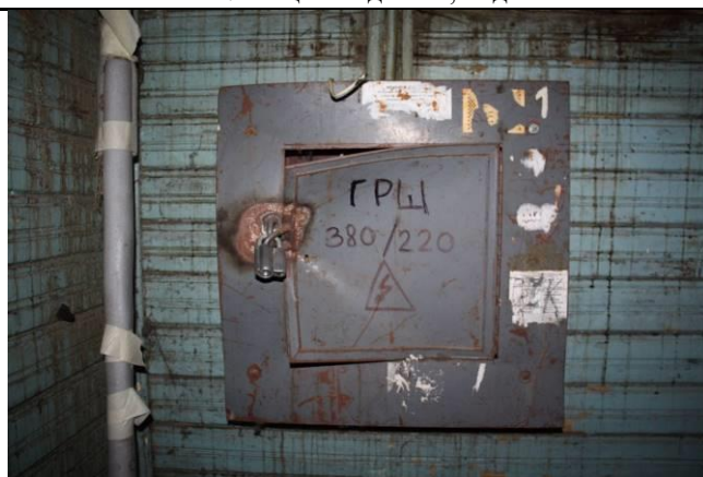
Фото 124: Главный распределительный щит здания
