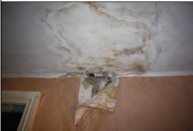
Фото 89: Состояние потолочного покрытия в ч.п.8
