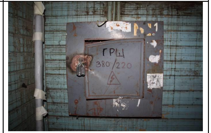
Фото 94: Главный распределительный щит здания
