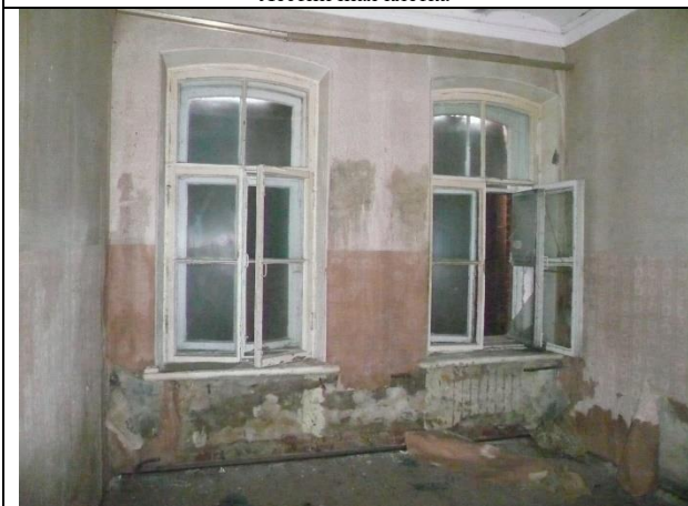
Фото №13 Состояние помещений в кв. 1
