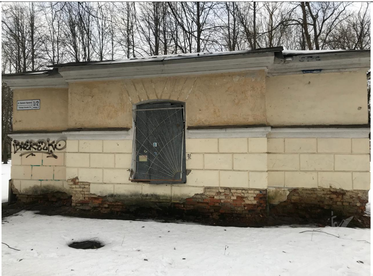
Фото 3. Оцениваемый объект недвижимости. Табличка с номером дома. Состояние стен и оконных проемов. Следы увлажнения цоколя
