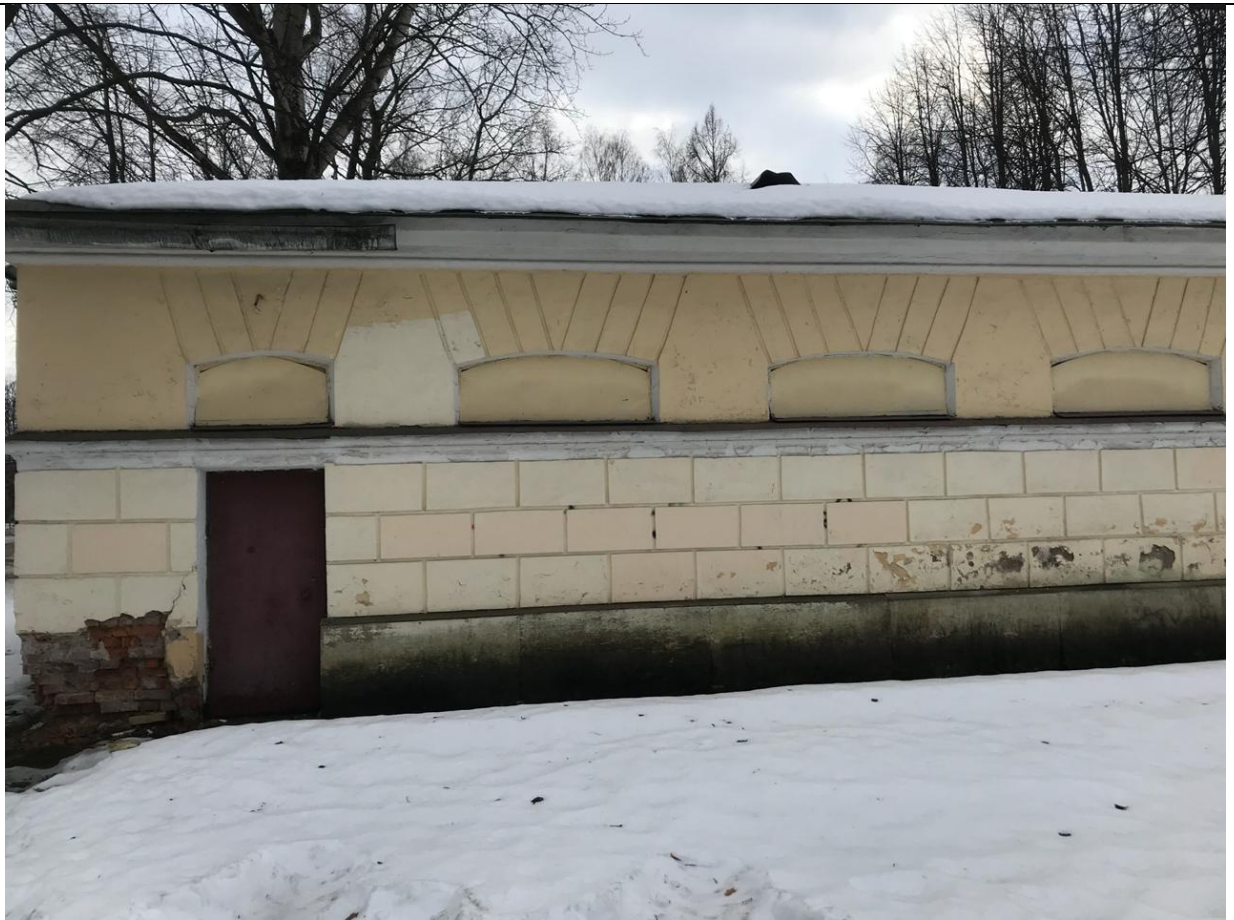
Фото 2. Оцениваемый объект недвижимости. Состояние стен. Следы увлажнения цоколя
