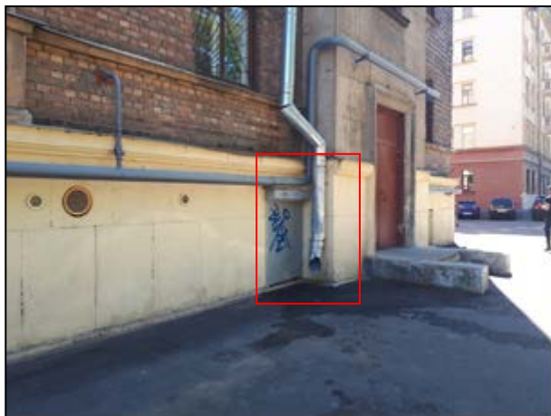
Фото 15. Отдельный вход со двора (в виде погрузочного окна, высотой не более 0,7 м)
