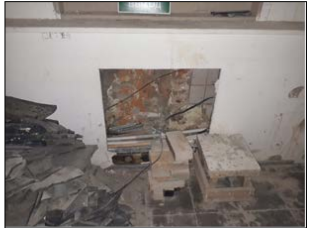
Фото 34. Состояние отделки (демонтированы радиаторы)
