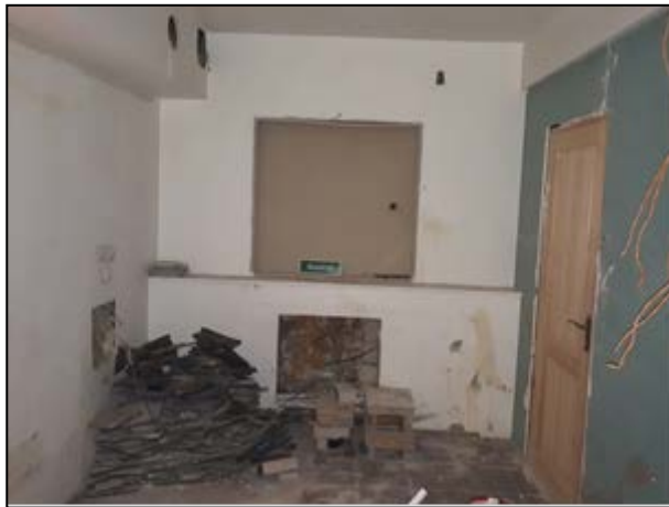
Фото 35. Состояние отделки ч.п. 4 (незарегистрированный организованный проход из смежного пом. 12-Н)
