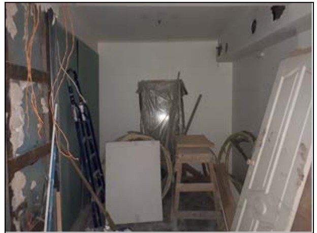
Фото 36. Состояние отделки ч.п. 4
