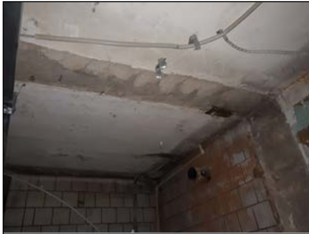
Фото 27. Состояние отделки (демонтирована часть стены между ч.п.)
