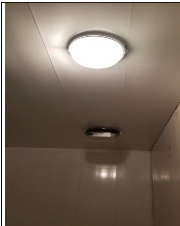
Фото 27. Общий вид и типичное состояние потолка в объекта оценки.
