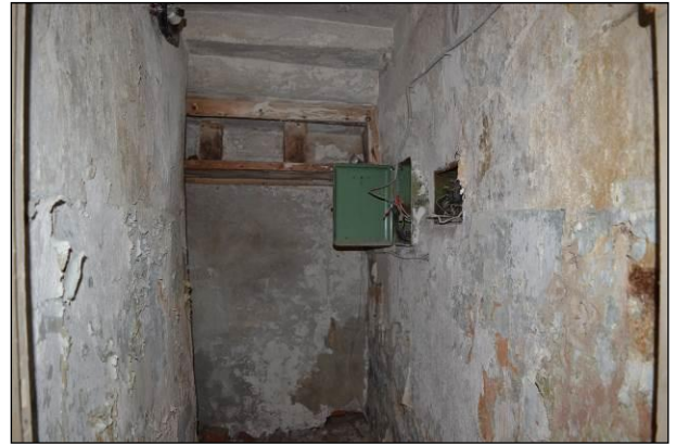
Фото 46. Электросчетчик в помещении
