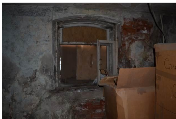
Фото 31. Состояние окон в помещении
