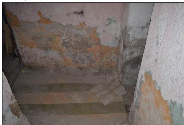
Фото 28. Состояние пола в помещении
