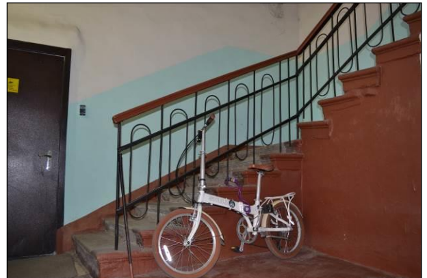
Фото 53. Состояние и общий вид парадной
