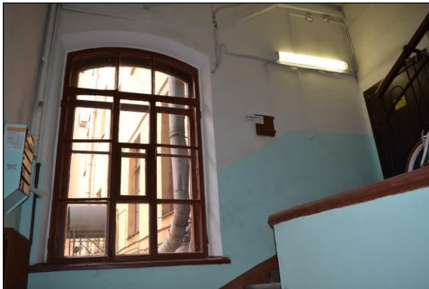
Фото 52. Состояние и общий вид парадной
