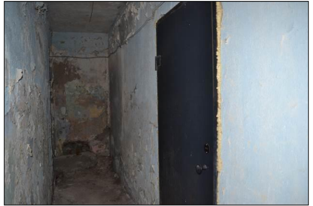
Фото 40. Часть помещения 7 (металлическая дверь – вход со стороны дворовой территории, ключ утерян, доступ со стороны двора не предоставлен)
