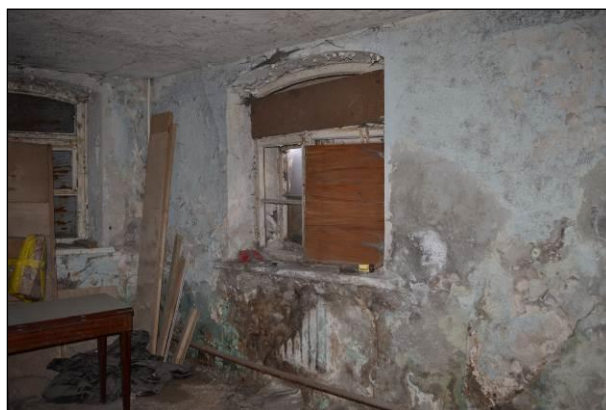
Фото 30. Общий вид помещения 5 (объединено с помещением 6), окна на угол наб. Мойки и Почтамтского переулка
