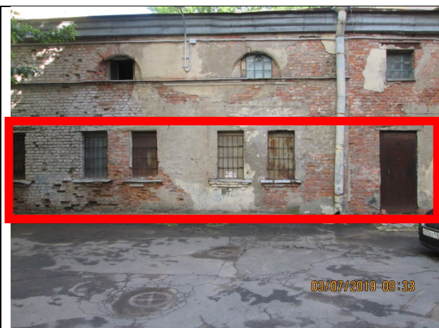
Фото 8. Общий вход в Объект оценки со двора и окна Объекта оценки, выходящие во двор.
