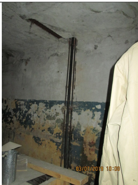
Фото 12. Часть помещения 1. Состояние стен.
