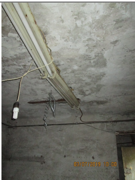
Фото 11. Часть помещения 1. Состояние стен и потолка.
