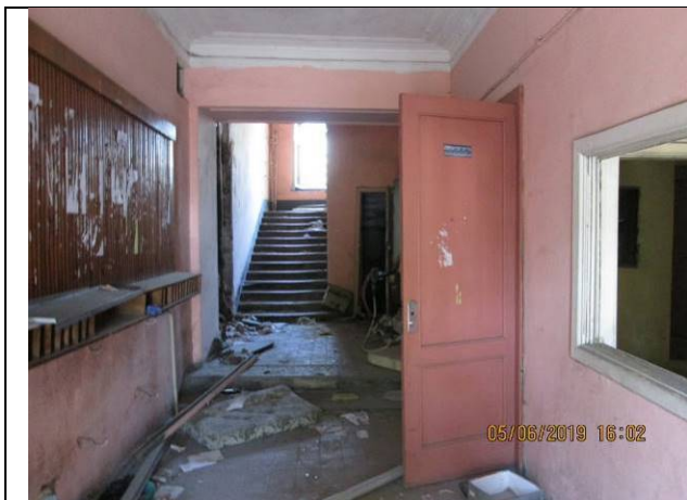
Фото 33. Состояние лестничной клетки №1
