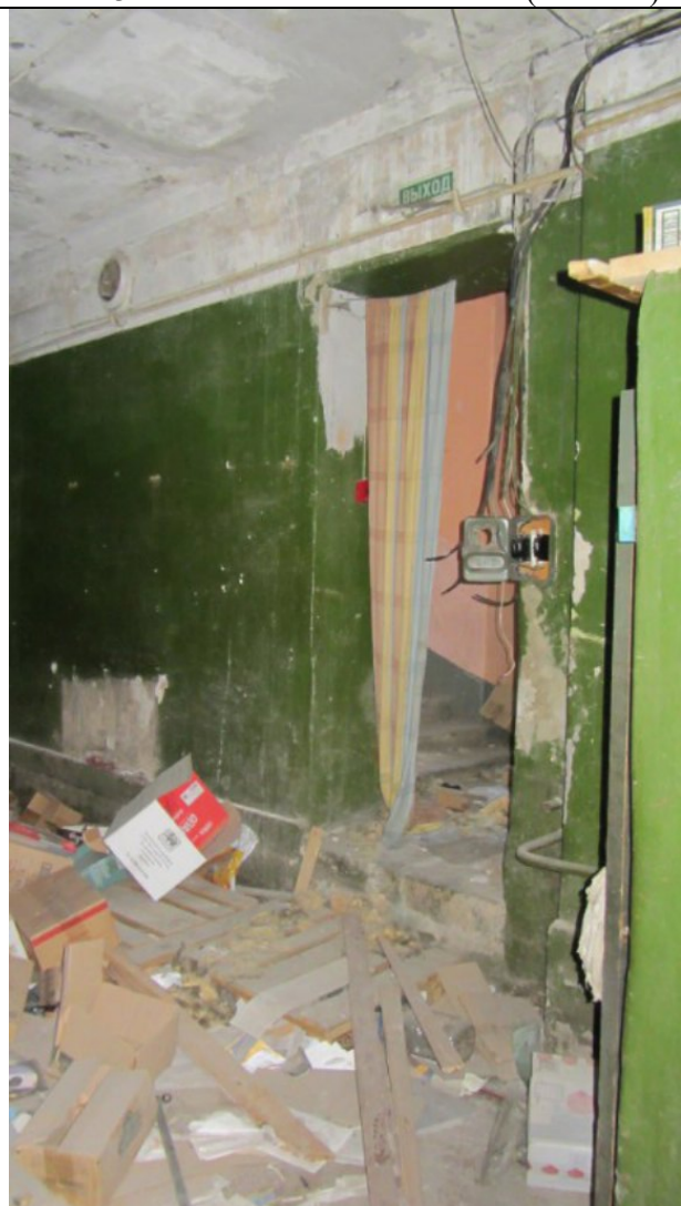
Фото 45. Состояние ч.п.1 пом. 4С-Н (вид на выход на лестничную клетку)
