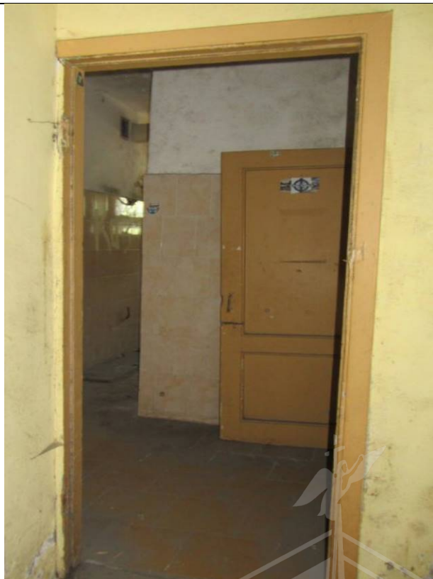
Фото 60. Состояние ч.п. 2 пом. 3С-Н (проход к ч.п. 3 и 4)
