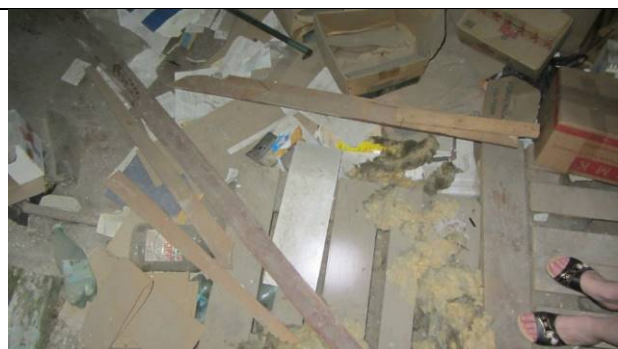
Фото 44. Состояние ч.п.1 пом. 4С-Н (пол)
