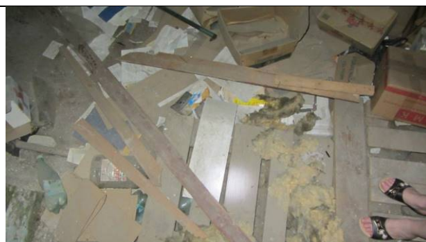
Фото 44. Состояние ч.п.1 пом. 4С-Н (пол)
