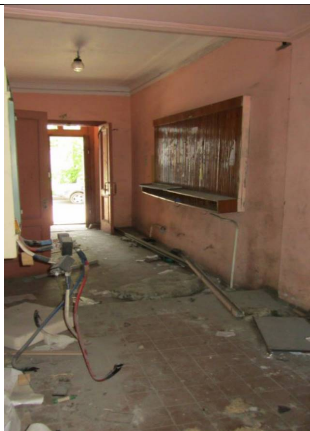
Фото 30. Состояние лестничной клетки №1
