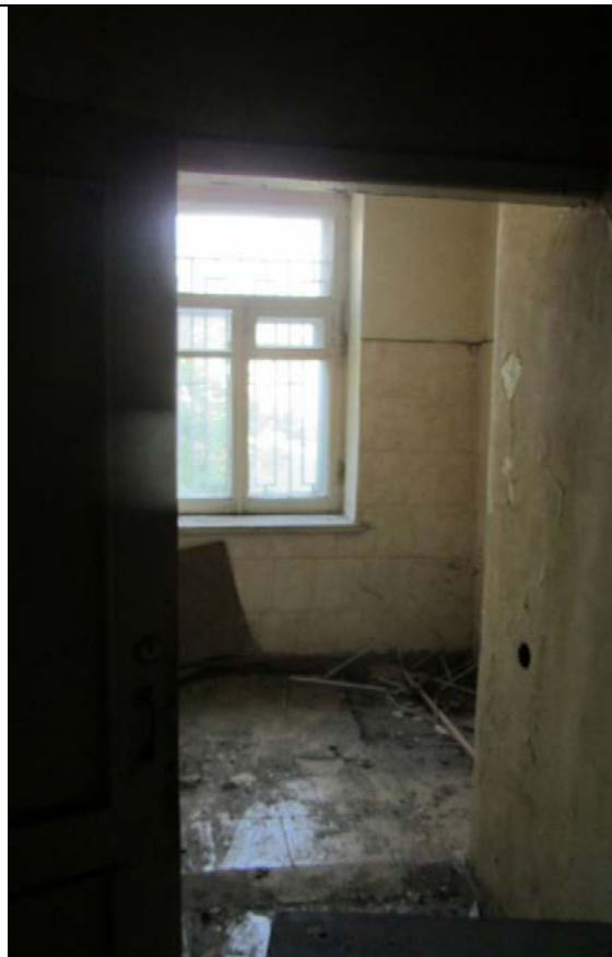
Фото 97. Состояние ч.п.1 пом. 2С-Н (вид на ч.п.3)
