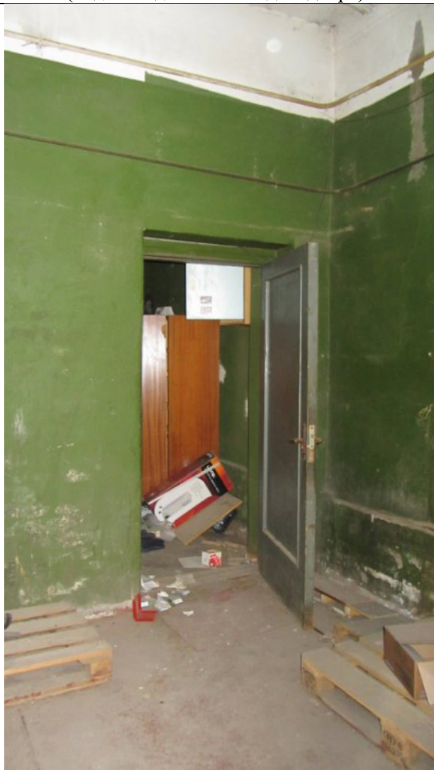
Фото 42. Состояние ч.п.1 пом. 4С-Н (проход в ч.п. 3)
