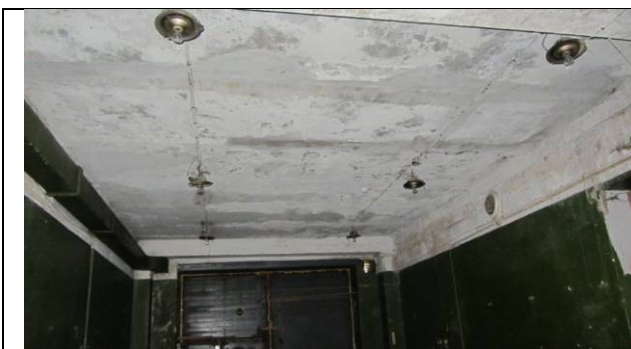
Фото 43. Состояние ч.п.1 пом. 4С-Н (потолок)
