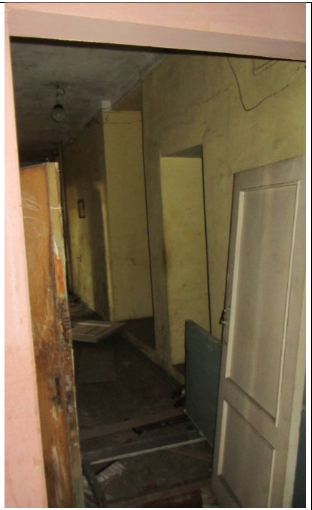
Фото 86. Состояние ч.п. 1 пом. 3С-Н (вид на вход в пом. 3С-Н с лестничной клетки №2)
