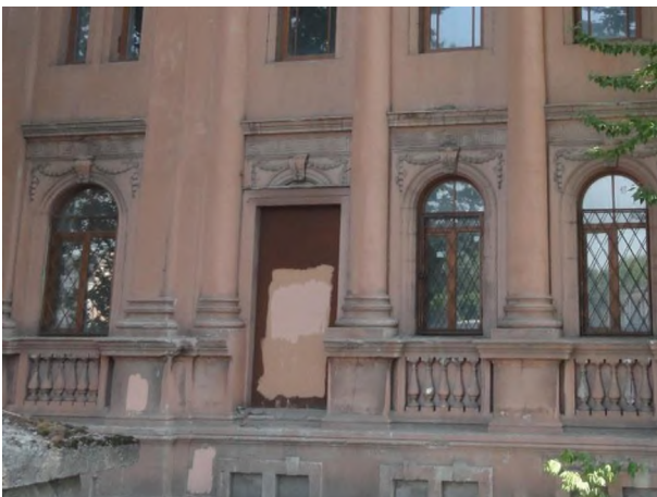
Фото 11. Вид отдельного схода со стороны Песочной набережной
