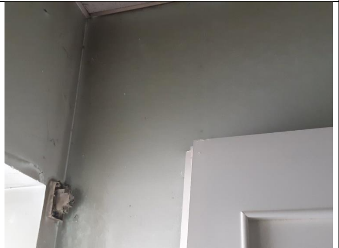
Фото 22. Состояние внутренней отделки помещения.
