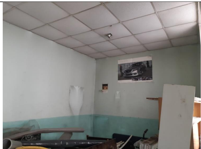
Фото 14. Состояние внутренней отделки помещения.
