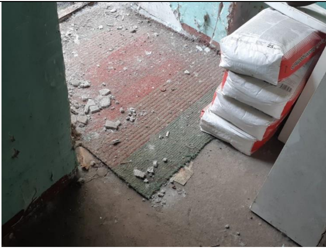
Фото 19. Состояние внутренней отделки помещения.
