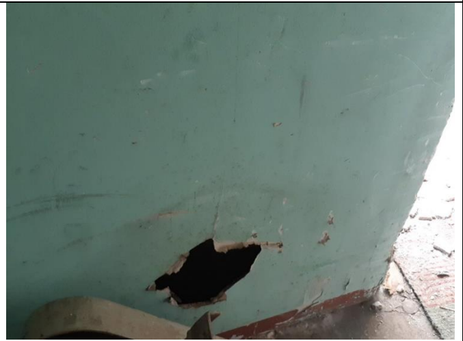
Фото 20 . Состояние внутренней отделки помещения.
