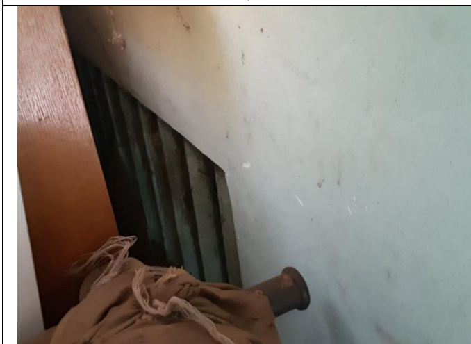
Фото 15. Состояние внутренней отделки помещения.
