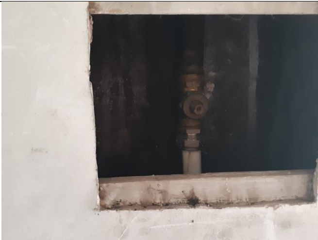
Фото 21. Состояние внутренней отделки помещения.
