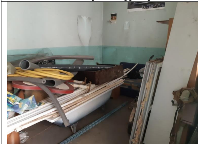
Фото 13. Состояние внутренней отделки помещения.
