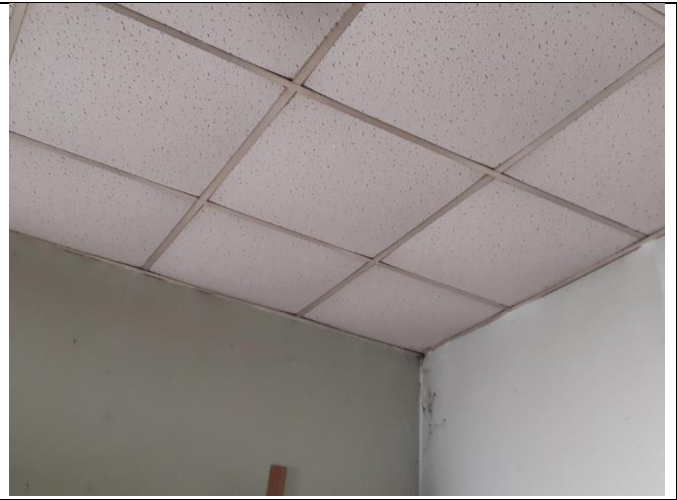
Фото 18. Состояние внутренней отделки помещения.
