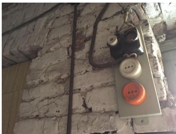
Фото 22. Общий вид оцениваемого помещения; электричество (утрачено)
