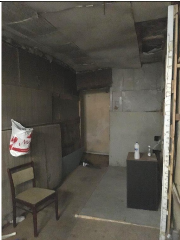
Фото 1. Ч. п. №1. Санитарно-технические устройства демонтированы
