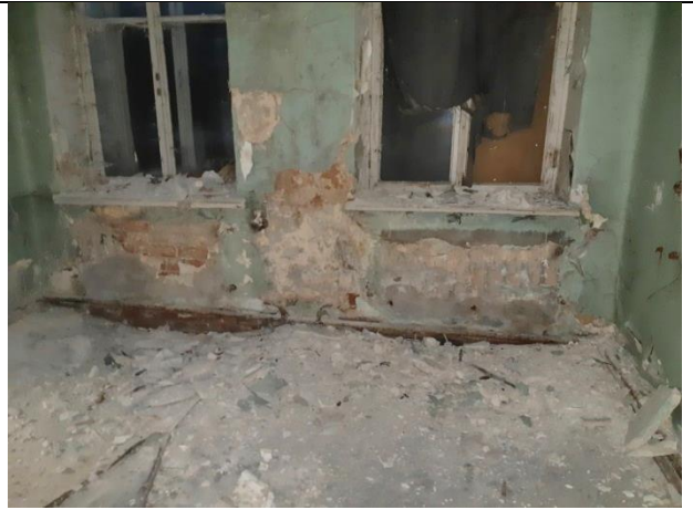
Фото 8. Состояние внутренней отделки помещений Объекта оценки. Демонтированные радиаторы
