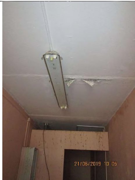
Фото 18. Общий вид и типичное состояние потолка в объекте оценки.
