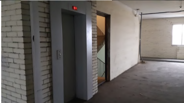
Фото 11. Лифт и лестничная клетка на 9 этаже.
