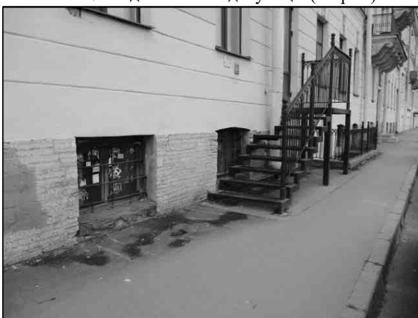
Фото 9. Типичное состояние оконных проемов, с ориентацией – на улицу
