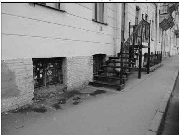
Фото 9. Типичное состояние оконных проемов, с ориентацией – на улицу
