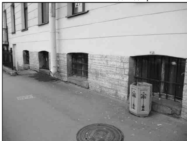
Фото 10. Типичное состояние оконных проемов, с ориентацией – на улицу
