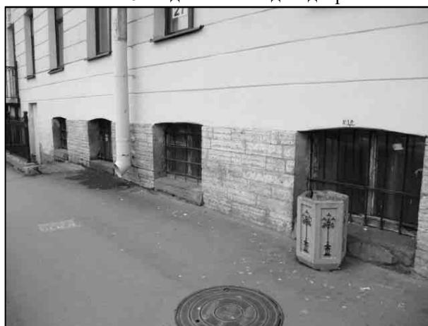
Фото 10. Типичное состояние оконных проемов, с ориентацией – на улицу
