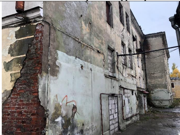
Фото 11. Состояние фасада, окон
