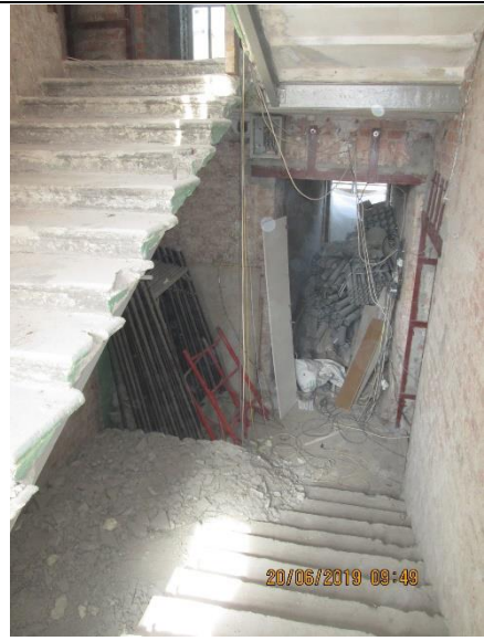
Фото 16. Помещение 5-Н (предположительно), входящее в состав Объекта оценки. Вид на общий вход с улицы.
