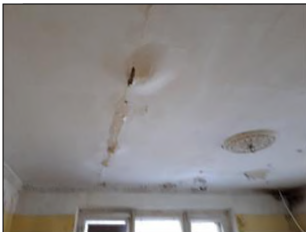
Фото 21. Состояние отделки потолка помещения
