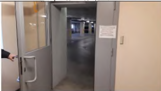
Фото 31. Типовое состояние лестничной клетки.
