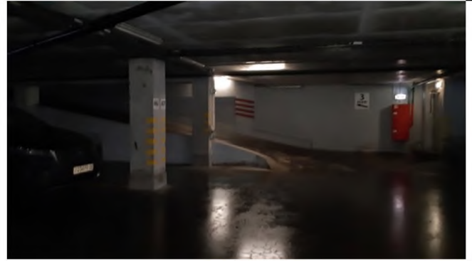
Фото 12. Типовое состояние 19-Н (проезд между этажами)
