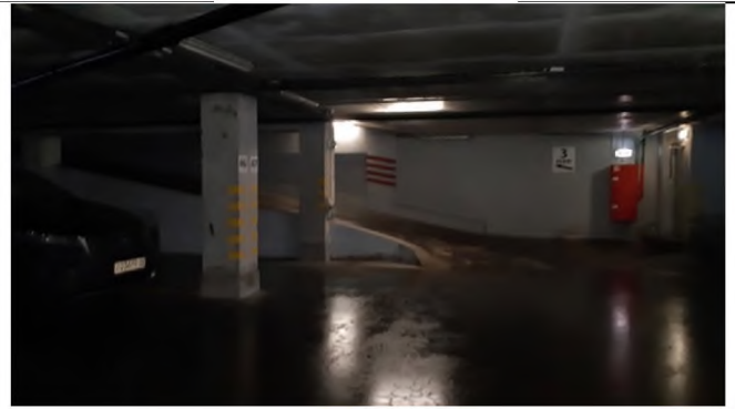
Фото 12. Типовое состояние 19-Н (проезд между этажами)
