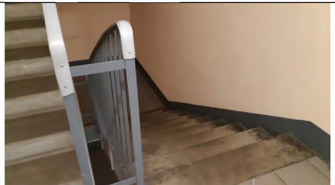
Фото 32. Типовое состояние лестничной клетки.
