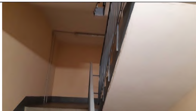
Фото 33. Типовое состояние лестничной клетки.
