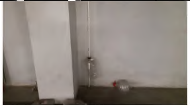
Фото 28. Типовое состояние помещения 19-Н (3 этаж). Проведен водопровод.
