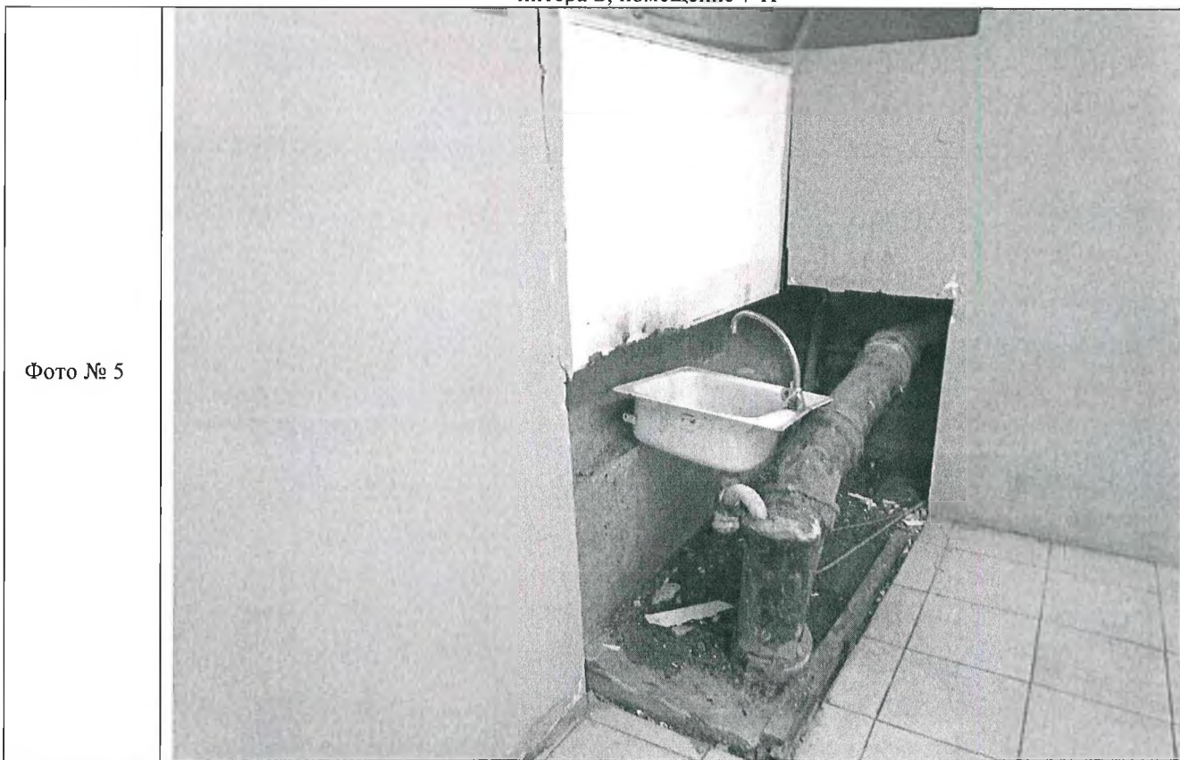
Описание: В ч.п. 1 Объекта установлено сантехническое оборудование (раковина)
