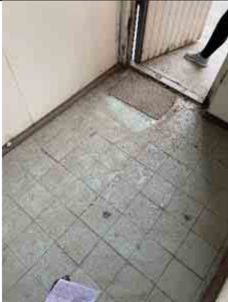
Фото №13 Состояние пола
