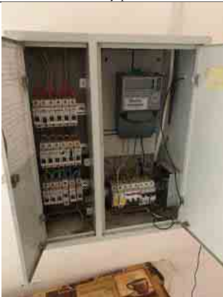
Фото №21 Электрический щиток
