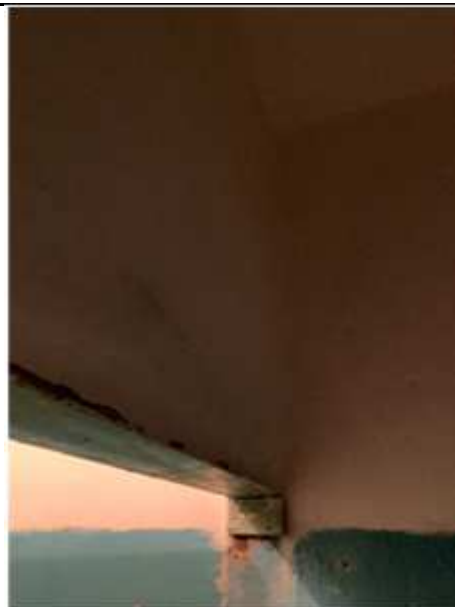
Фото №20 Состояние стен ванной
