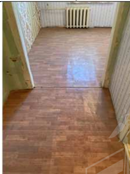
Фото №12 Состояние пола
