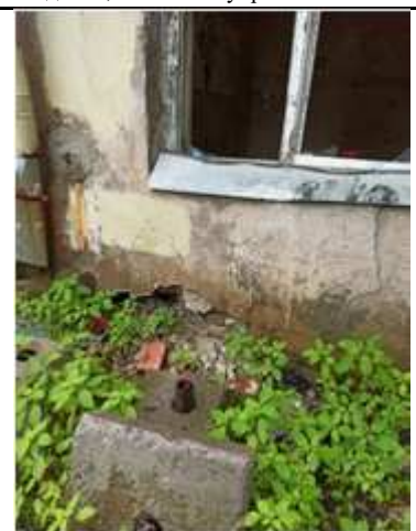
Фото № 25. Здание, лит. А. Повреждения несущих конструкций
