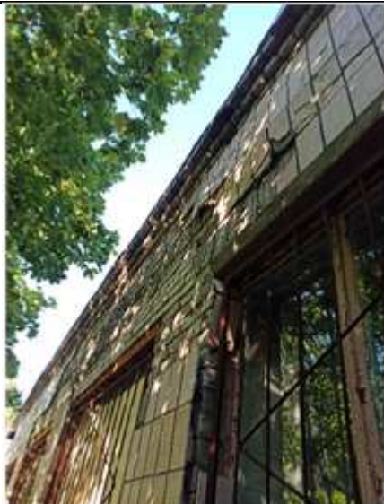
Фото №12: Повреждения отделки фасада
