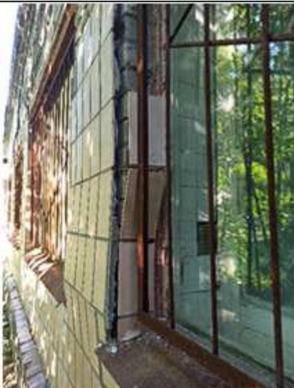
Фото №11: Повреждения отделки фасада
