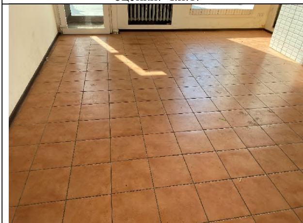
Фото 11. Состояние внутренней отделки Объекта оценки. Ч.п.1.
