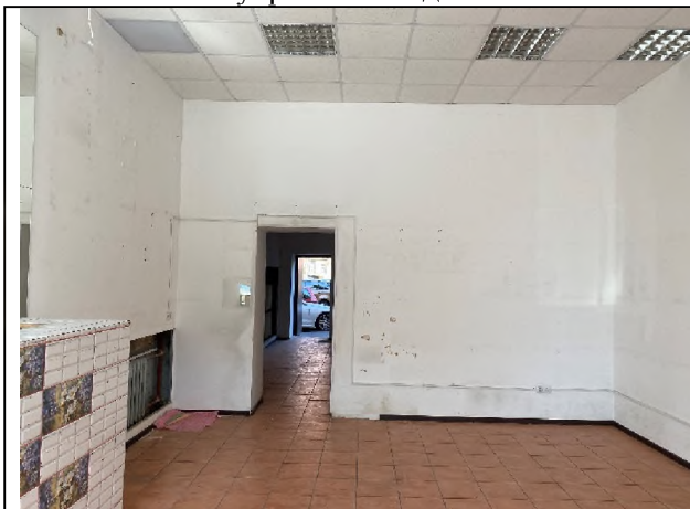
Фото 7. Состояние внутренней отделки Объекта оценки. Ч.п.1.
