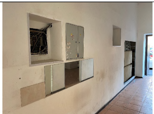
Фото 14. Состояние внутренней отделки Объекта оценки. Ч.п.3.
