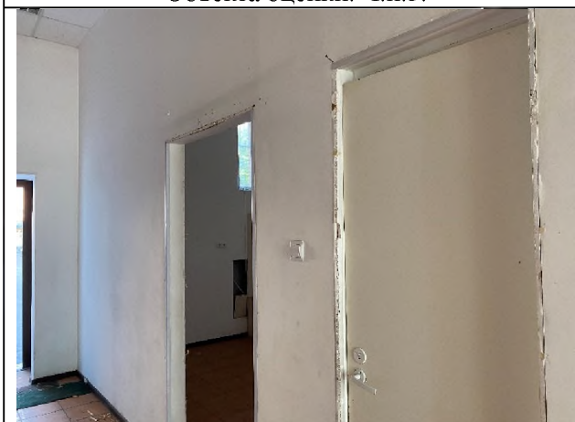
Фото 15. Состояние внутренней отделки Объекта оценки. Ч.п.3.
