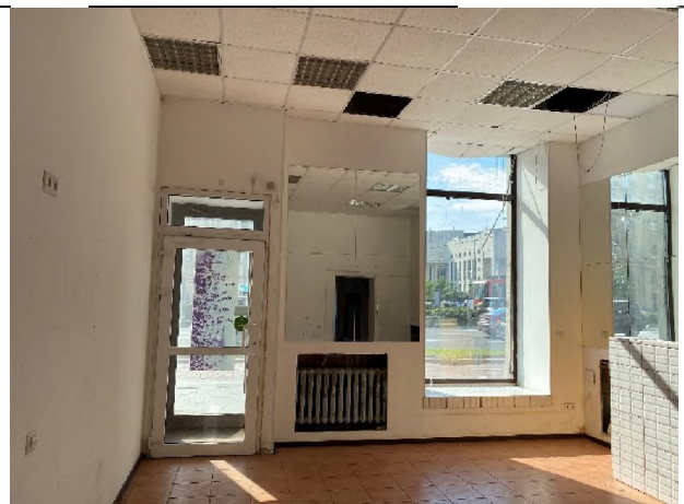
Фото 8. Состояние внутренней отделки Объекта оценки. Ч.п.1.
