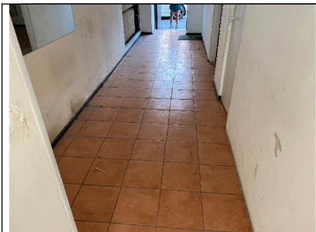
Фото 13. Состояние внутренней отделки Объекта оценки. Ч.п.3.
